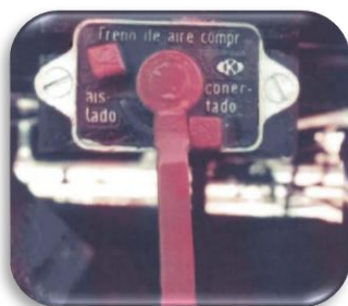
Ilustración 5: Llave de aislamiento en posición “conectado”
